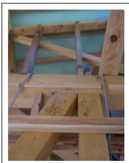
木構造軸組と接合部 樹脂充填の跡が白く散見される。
