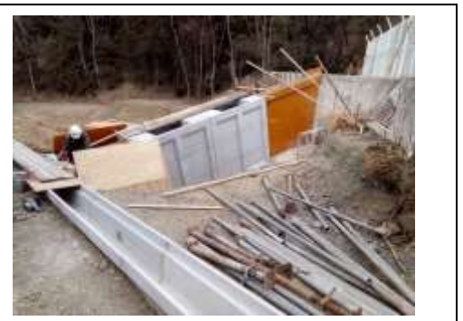
写真-7 自由勾配側溝 (2)
