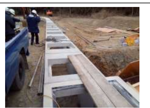
写真-6 自由勾配側溝 (1)
