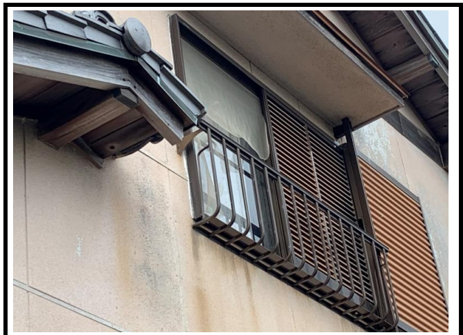
雨戸破損箇所
