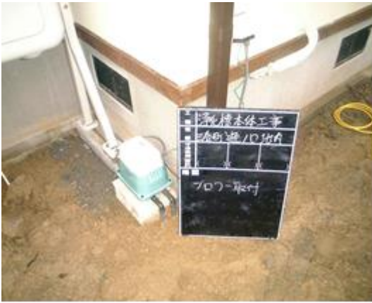
【写真9】ブロワ設置状況が分かる写真
