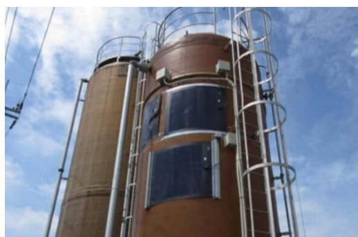
石油タンクに設置されたペロブスカイト太陽電池を活用 した太陽光発電
