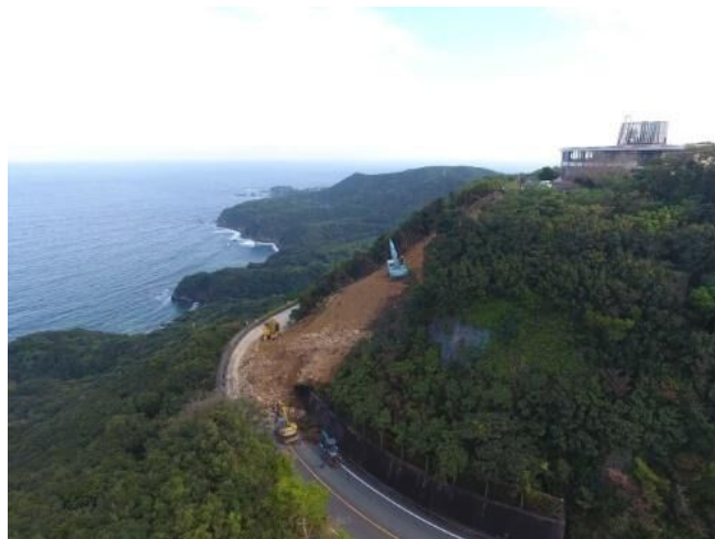
図 土砂崩落による通行止め
