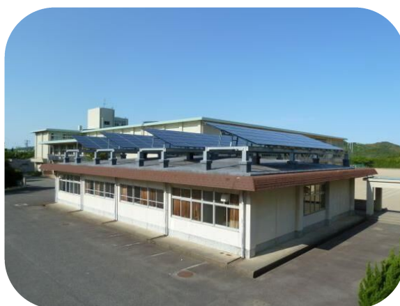
図 鳥羽東中学校（運動場が津波避難所指定）に導入された太陽光発電
