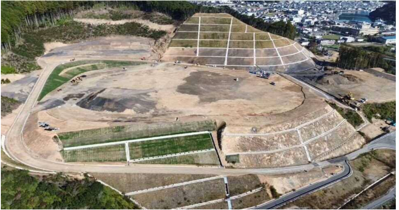
図 現場状況写真(令和6年12月3日撮影)
