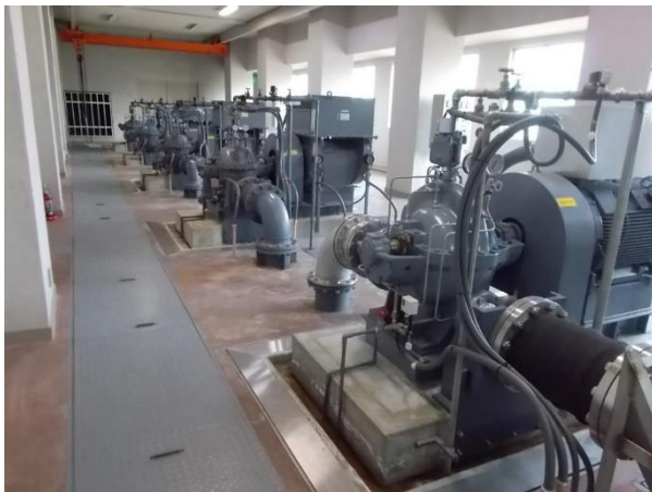
岩倉水源地送水ポンプ
