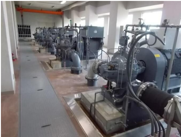
岩倉水源地送水ポンプ
