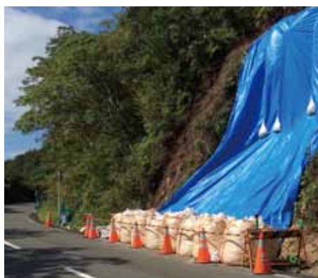
▶ パールロードの崖崩れ
