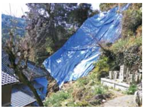
台風14号の影響により被災した妙性寺裏墓地用地
