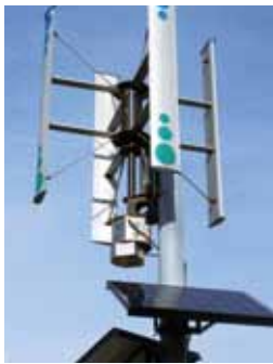
市内で回るハイブリッド型 小型風力発電機
