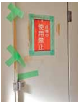
2年間使用禁止のままの トイレもある
