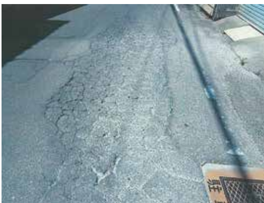
路面陥没が多くなってきている市道本町商船学校線
