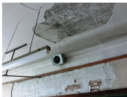
写真 1-14 天井・壁漆喰の剥離 （3 階旧普通教室）
