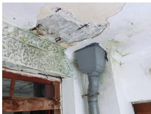
写真 1-13 雨漏りによる天井漆喰の剥離と 壁の汚損（講堂）
