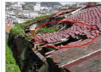
柱・はりの破損や変形が著しく崩壊の危険がある例(国土交通省資料)
