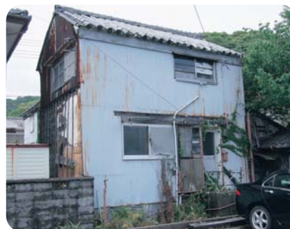
傷みがひどく早期の改修が望まれる米蔵
