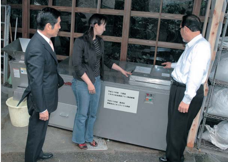
市では、事業所から出る生ごみの減量化を進めています。県と市の補助を受けて、サン浦島に設置された生ごみ処理機です。
