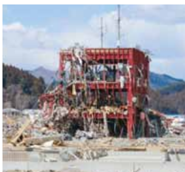
南三陸町防災対策庁舎
